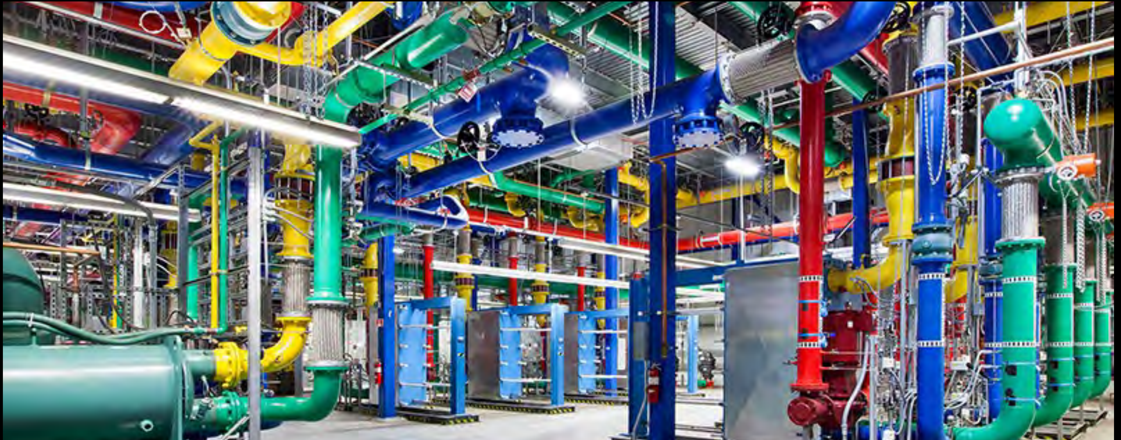
Kühlkreise von Google betriebenen Rechenzentrum in Oregon Credit: Connie Zhou/Google/Zuma
