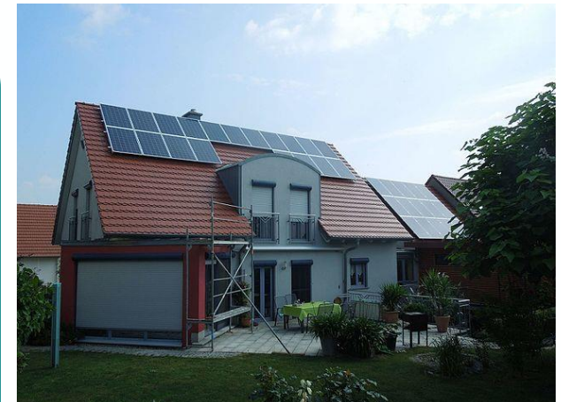
Solarförderung in Osnabrück durch das Programm „Photovoltaik-Plus“ Einfamilienhaus mit PV-Anlagen
