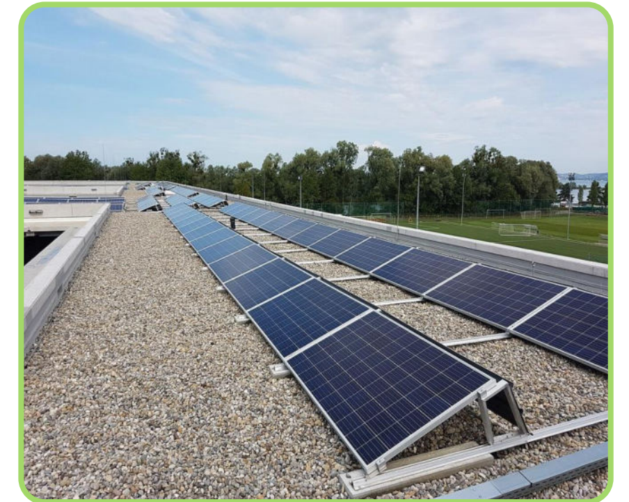
Dach-PV-Anlage auf einer öffentlichen Schule Quelle: Wikimedia Commons
