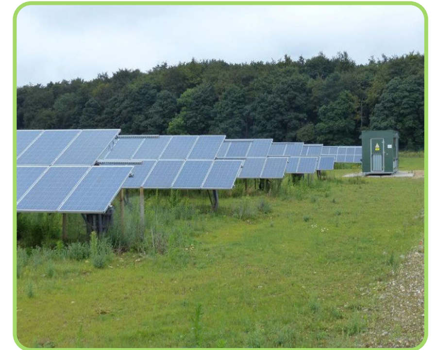
Freiflächen PV-Anlage Quelle: Wikimedia Commons
